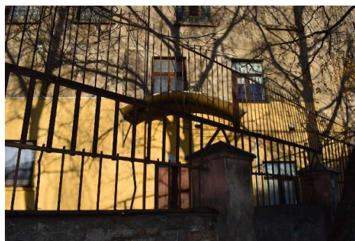
3.4.4. att. Teritorijas dienvidu daļas nožogojuma bojājumi
