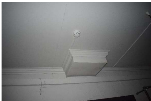
5.3.1.1. att. Uzstādītais dūmu detektors
