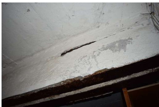
4.6.1.3. att. Pastiprināta pārseguma siju un stierojuma korozija
