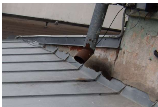
4.8.2.12. att. Būtiska lietus ūdens novadīšanas sistēmas stāvvada korozija
