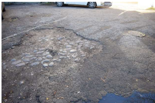
3.1.3. att. Asfaltbetona seguma bojājumi
