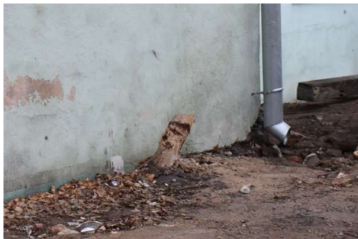
3.3.1. att. Koka celms pie ēkas pamatu konstrukcijas
