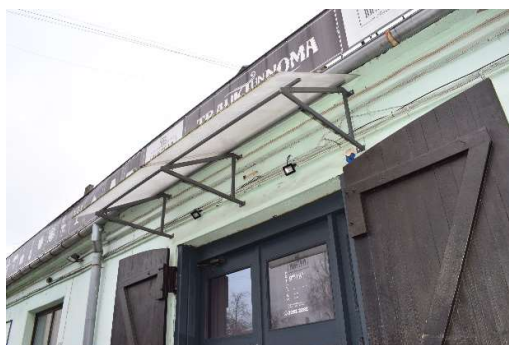
4.2.5.2. att. Nebūtiska metāla siju korozija
