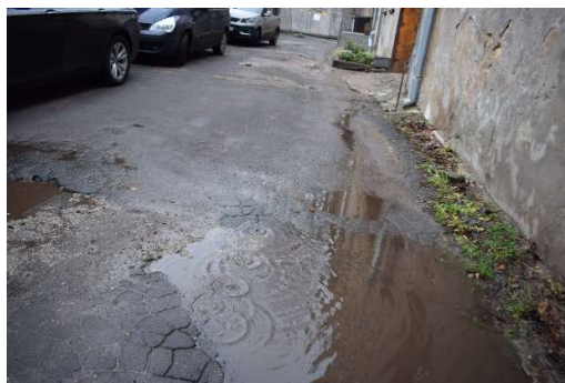
3.1.6. att. Asfaltbetona seguma bojājumi
