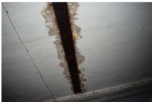
4.6.1.1. att. Pastiprināta pārseguma siju korozija
