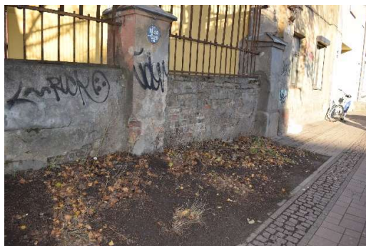
3.4.1. att. Teritorijas dienvidu daļas nožogojuma bojājumi
