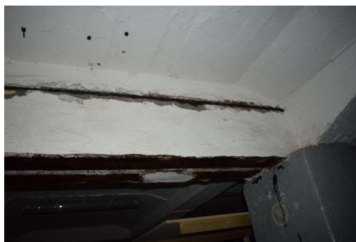
4.6.1.4. att. Pastiprināta pārseguma siju un stierojuma korozija
