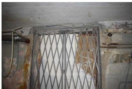
4.13.2.4. att. Durvis ēkas pagrabstāva ārsienā
