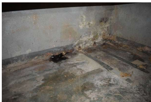
4.1.2.8. att. Kapilārā mitruma bojājumi
