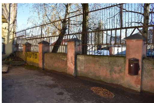
3.4.5. att. Teritorijas dienvidu daļas nožogojuma bojājumi
