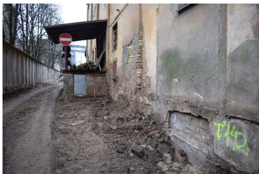
3.1.1. att. Asfaltbetona seguma bojājumi
