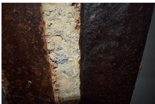
4.6.1.5. att. Pastiprināta pārseguma siju korozija
