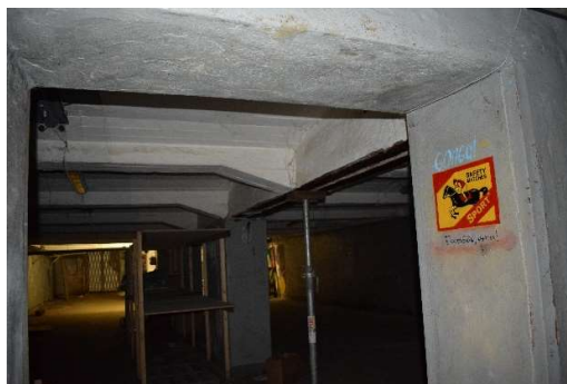
4.6.1.2. att. Pastiprināta pārseguma siju korozija, uzstādīts pagaidu balsts
