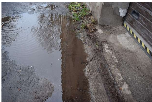
3.1.5. att. Asfaltbetona seguma bojājumi
