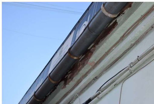
4.2.3.2. att. Lokāla mūra erozija
