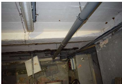
5.2.1.2. att. Sadzīves kanalizācijas cauruļvads
