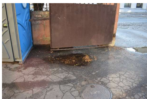
3.4.6. att. Teritorijas dienvidu daļas nožogojuma bojājumi
