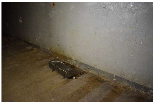
4.1.2.5. att. Kapilārā mitruma bojājumi
