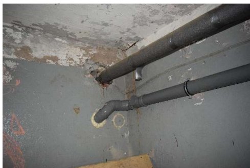
5.2.1.1. att. Sadzīves kanalizācijas izvads
