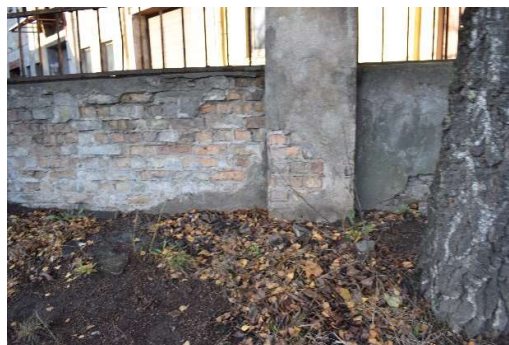
3.4.2. att. Teritorijas dienvidu daļas nožogojuma bojājumi
