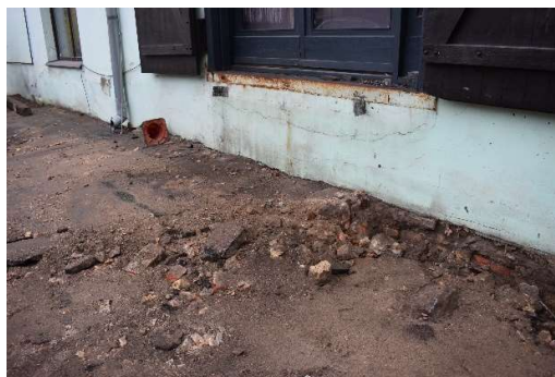
3.1.2. att. Asfaltbetona seguma bojājumi
