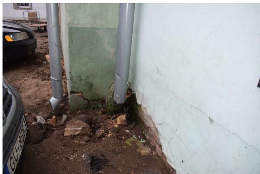
4.2.3.1. att. Lokāla mūra erozija
