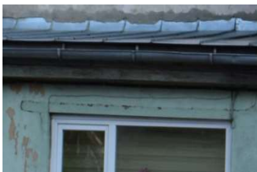
4.2.5.1. att. Nebūtiska metāla siju korozija
