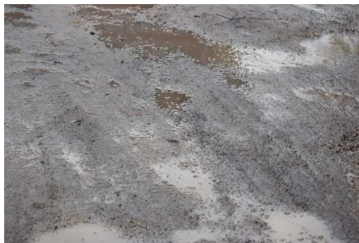
3.1.4. att. Asfaltbetona seguma bojājumi
