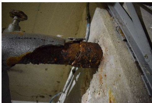
5.1.1.1. att. Aukstā ūdensvada ievads, pastiprināta cauruļvada korozija ar nehermētiskuma pazīmēm
