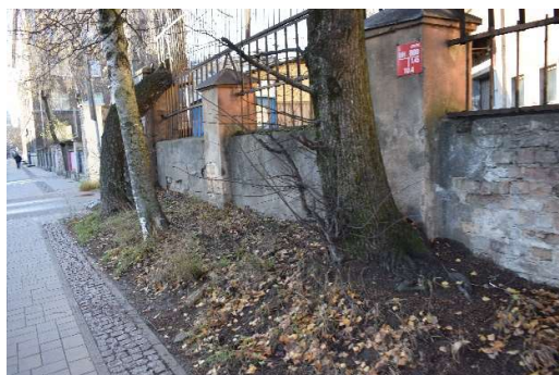
3.4.3. att. Teritorijas dienvidu daļas nožogojuma bojājumi
