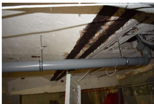
4.6.1.6. att. Pastiprināta pārseguma siju korozija
