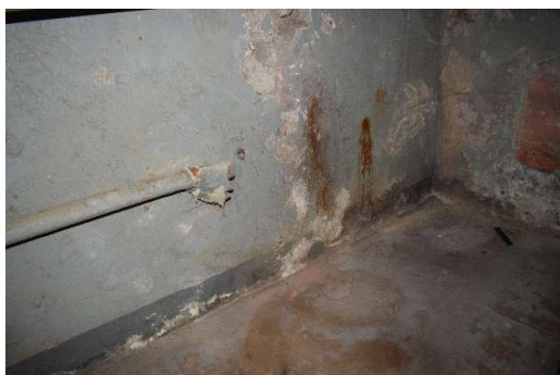
4.1.2.7. att. Kapilārā mitruma bojājumi
