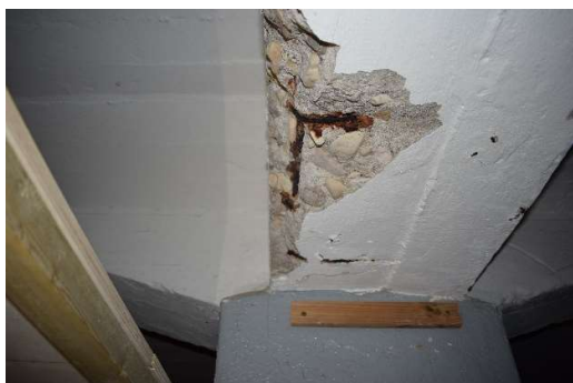
4.6.1.7. att. Pastiprināta pārseguma stierojuma korozija
