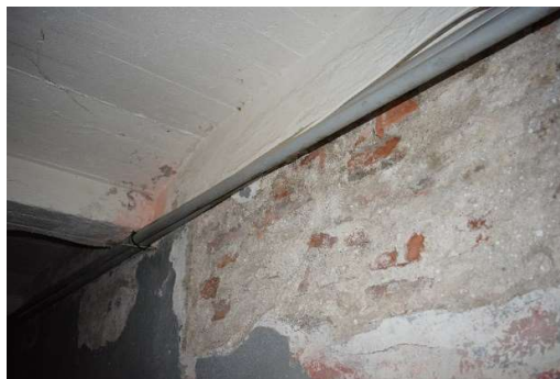
4.1.2.6. att. Kapilārā mitruma bojājumi
