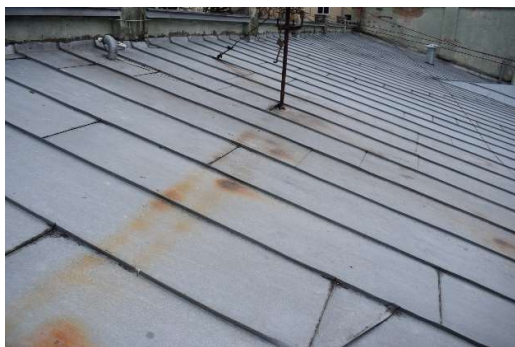
4.8.2.3. att. Jumta segums, nebūtiski pretkorozijas pārklājuma bojājumi
